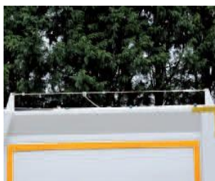
Sigurnosni sustav protiv padanja montiran na krovu
